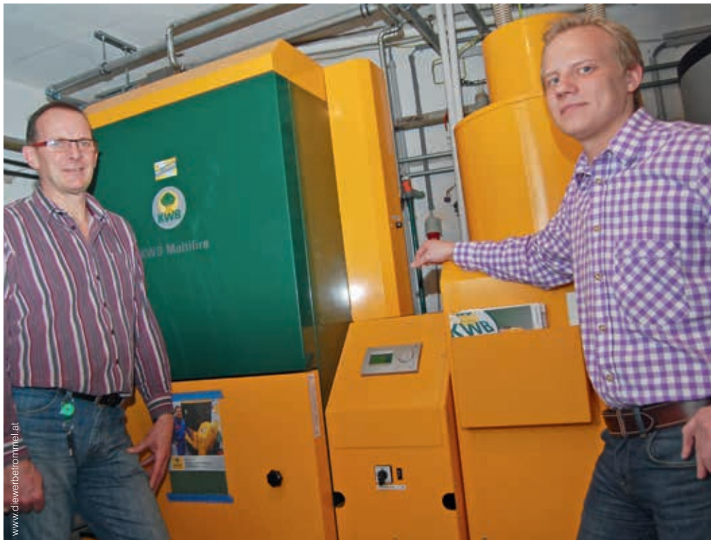
Herzstück der neuen Heizungsanlage im Wirtshaus zum Alten Kino: die KWB Pelletszentralheizung. Im Bild Wirt Helmut Grassmann und Markus Heinrichsberger von Haustechnik Bruckner.
